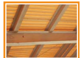
Vigas primarias y secundarias en FRP de Enduro
