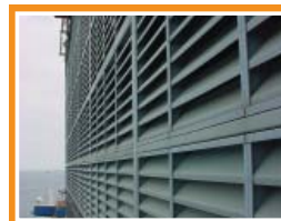
Rejillas de ventilación en FRP en una plataforma mar adentro
