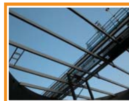
Elementos estructurales en FRP en una planta de tratamiento de agua
